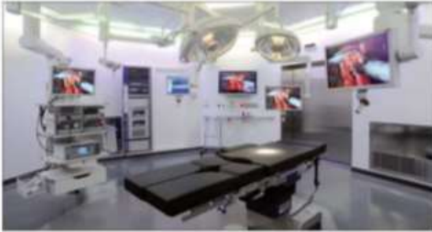
الشكل 1a تكوين نظام غرفة العمليات (KARL STORZ OR1 Tuttlingen, Germany)
